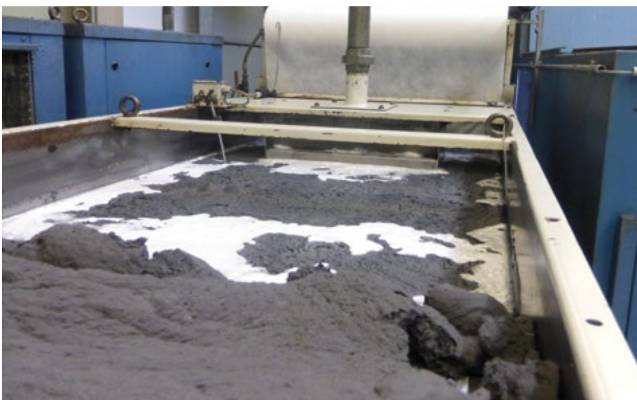
Blick in die Filtrieranlage.
